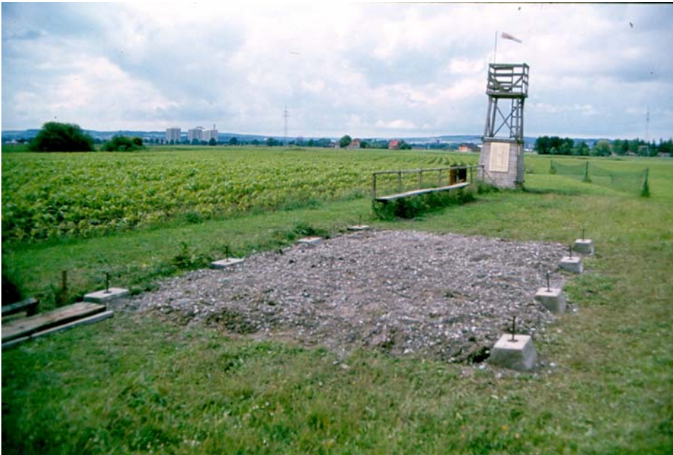
Bild 13: Das Fundament ist gelegt, im Hintergrund der alte Tower, davor das Schutznetz
